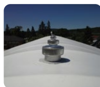
AÉRATEURS DE TOIT (MOTORISÉS OU NON)
